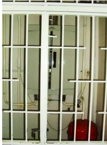
2.kép Tetőtéri Fégtherm gázkazán
